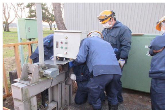
東北製造所 水門手動動作訓練
